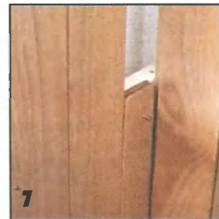
Во внутреннем углу расстояние между фанками составляет 3 мм.
